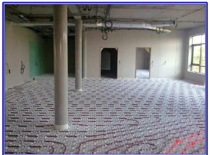
Plancher chauffant de la crèche
