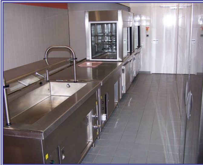
Ligne de self (côté cuisine)
